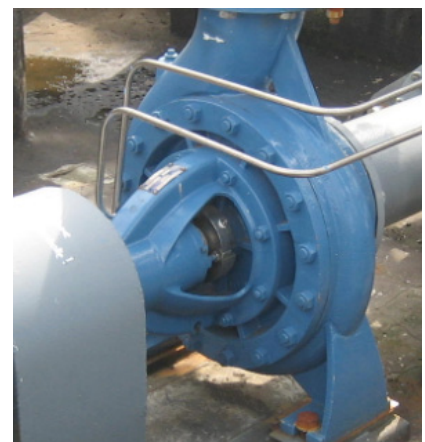
Umgebaute Pumpe mit einer neuen Gleitringdichtung und Rohrleitungen für Sperrmedium
