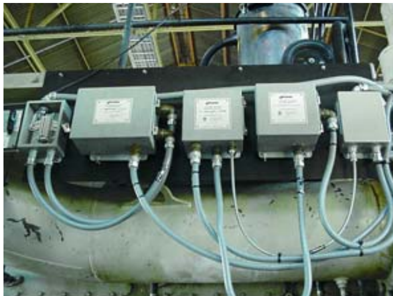
2 CPU-2000-Module von Altronic, die von Sulzer Enpro an einem Motor für ein Erdgaspipeline-Unternehmen in Kentucky montiert wurden.
