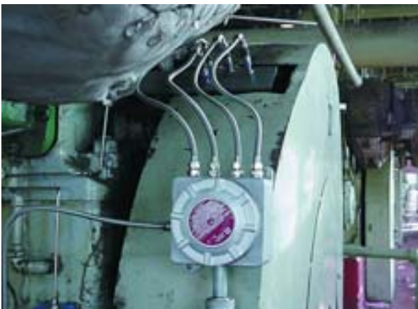
4 Magnetaufnehmerkabel, die zu einem CPU-2000-Logikmodul zurückführen. Installation und Instandhaltung solcher Zündsysteme erfordern geschultes und erfahrenes Personal.
