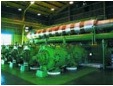
1 Sulzer Enpro Ignition & Control Systems vertreibt, installiert und wartet Zündsysteme wie hier bei einem großen Kompressor für den Erdgastransport.
