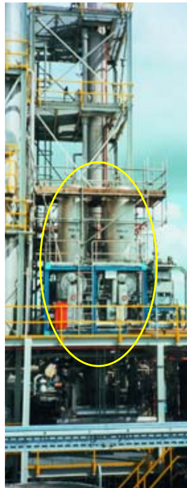
3 Die 1997 in die Niederlande gelieferte Dampfpermeationsanlage wurde in einen bestehenden Anlagenkomplex integriert.
