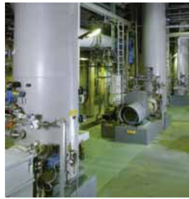
4 Typische MC®-Pumpenanordnungen. Der Füllstand der Stoffaufbereitung im Standrohr wird gemessen und gesteuert und sorgt somit für konstante Pumpenbetriebsbedingungen.
