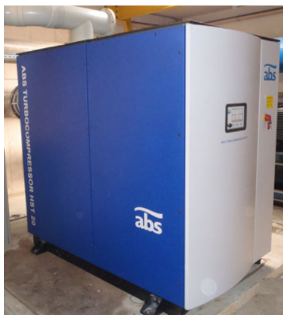
Turbocompresseur HST installé sur la station d'épuration de Laon
