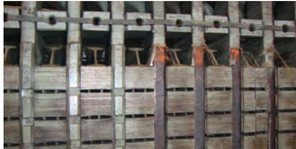
2 Stator mit wandernden Nutverschlusskeilen vor der Reparatur.
