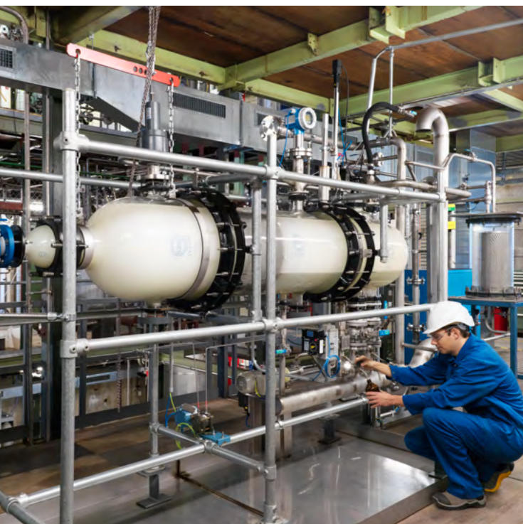
3 Pilotanlage im Entwicklungslabor in Winterthur, Schweiz.
