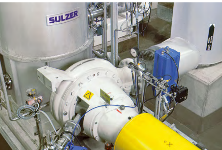
8 MCE-Pumpen mit integrierter Entgasungseinheit.
