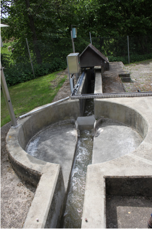
Vom Regenüberlaufbecken führt ein offener Kanal zum Zerkleinerer.
