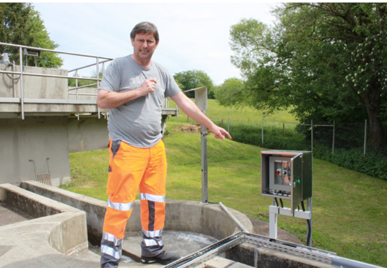
Über einen Schaltschrank am Schacht kann der Zerkleinerer manuell gestartet und gestoppt werden
