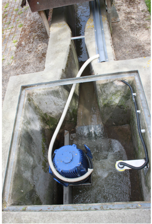
Die Ultraschall-Füllstandsmessung (rechts an der Schachtwand) schaltet den Zerkleinerer abhängig vom Wasserstand ein und aus.
