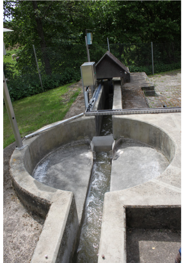
Vom Regenüberlaufbecken führt ein offener Kanal zum Zerkleinerer.
