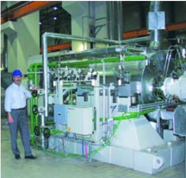
2 Kesselspeisepumpe im Braunkohlekraftwerk Lippendorf.
