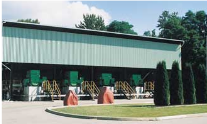
2 Die Pumpstation Sumas – 60 km südöstlich von Vancouver gelegen – ist eine der Pumpstationen der Transmountain Pipeline, bei der die neuen HSD-Pumpen von Sulzer Bingham verwendet werden.
