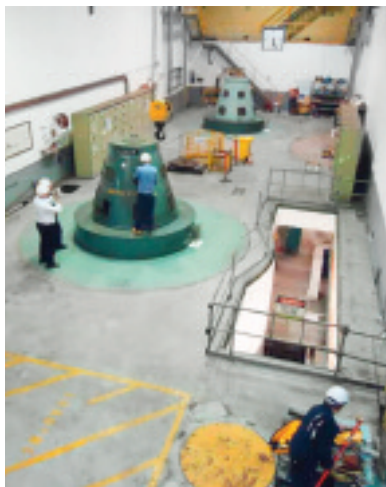
4 Blick in die Maschinenhalle des Barron-Gorge-Kraftwerks.
