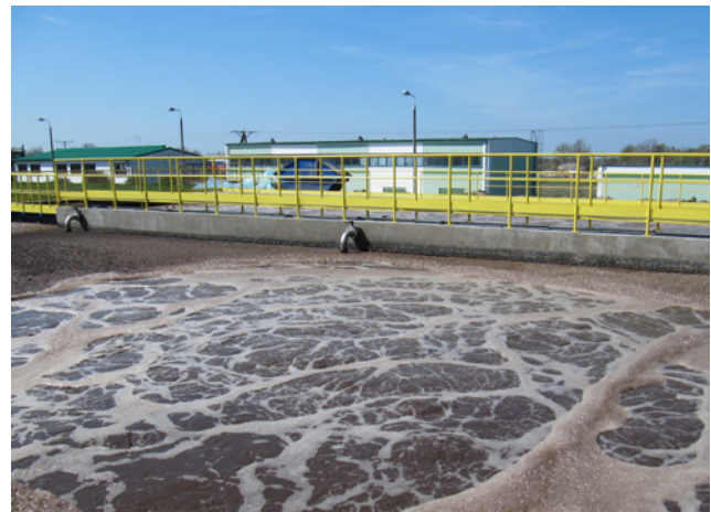
Kläranlage Pulawy in Polen
