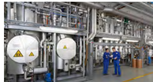
Abb. 14 2010 installierte Anlage zur Herstellung von Biokunststoff.
