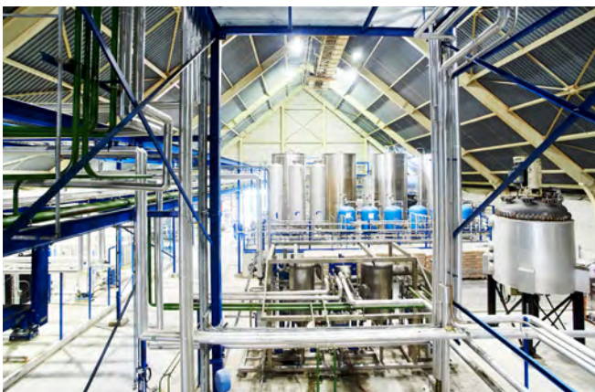
Abb. 2 Milchsäure-Prozessanlage von Futerro.
