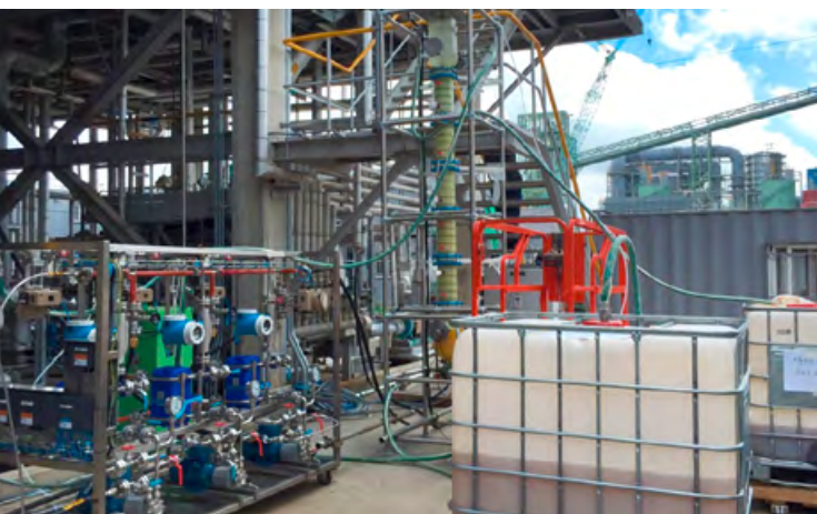
2 Installation der Pilotanlage beim Kunden in Südkorea.
