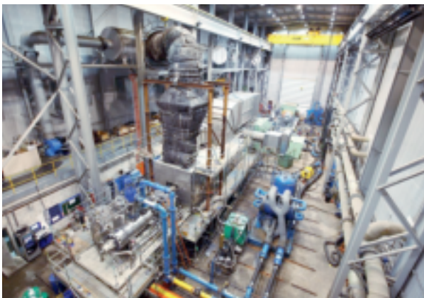
5 Probelauf einer Pumpe mit Gasturbinenantrieb bei Sulzer in Leeds (UK).
